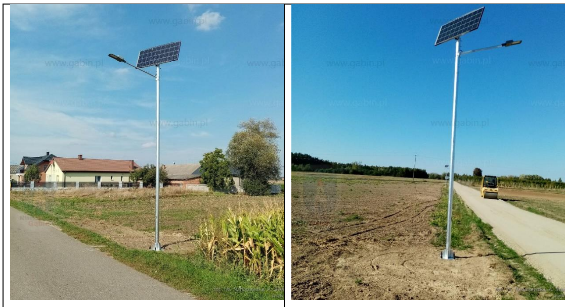
Energooszczędne lampy solarne typu LED zamontowane na terenie Miasta i Gminy Gąbin
