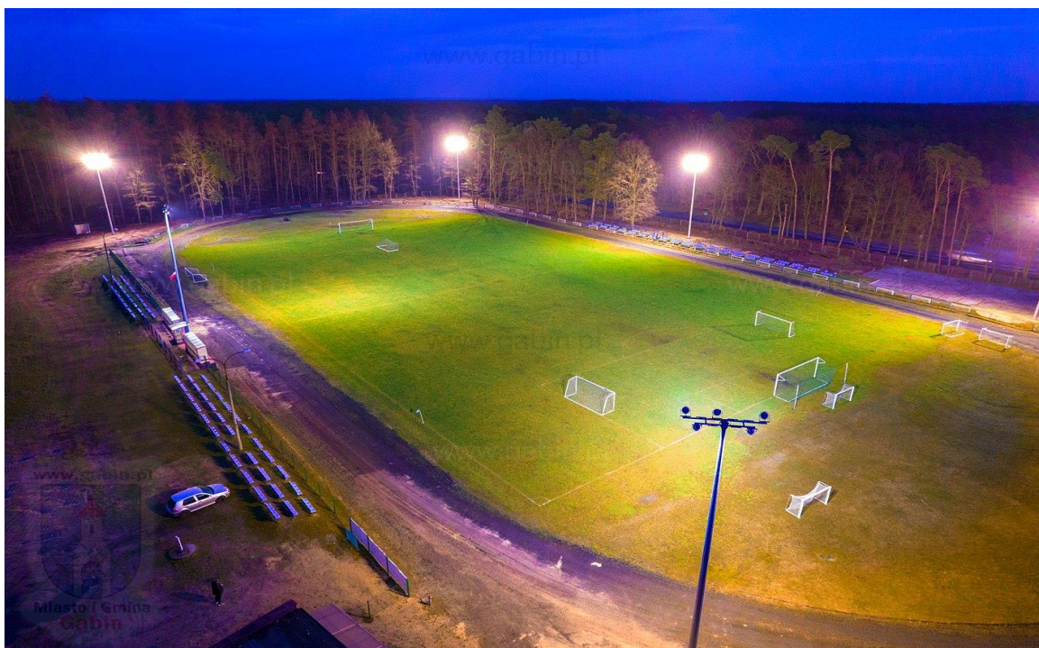
Oświetlenie bieżni i płyty boiska na stadionie leśnym w Gąbinie
